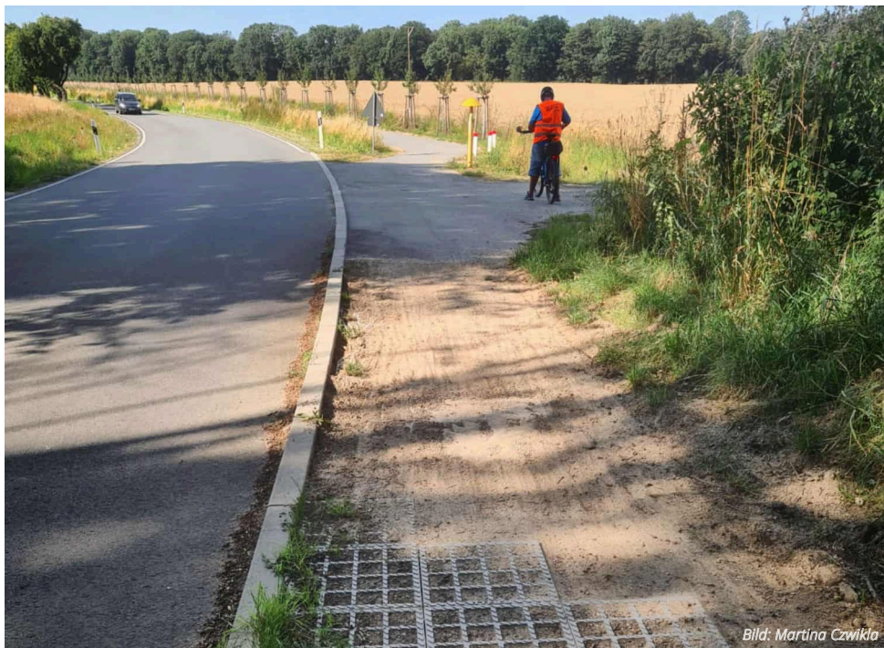
Schäden am Ostseeküsten-Radweg bei Fliemsdorf
